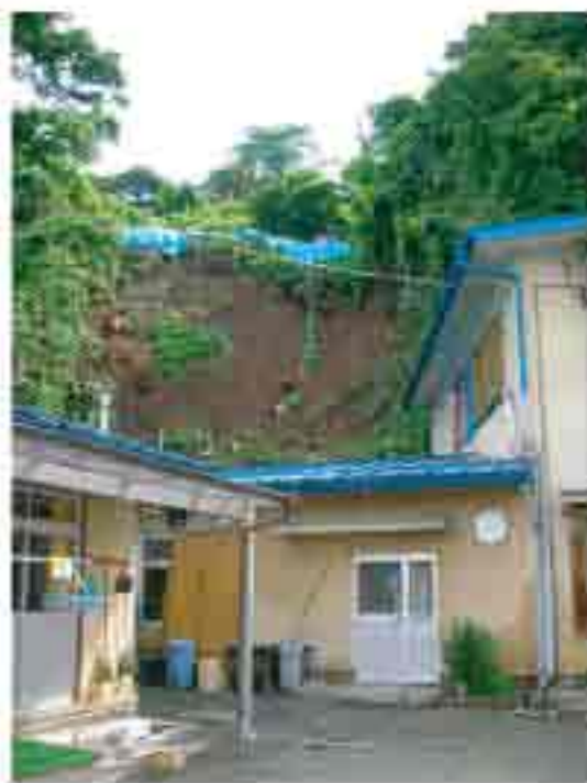
写真2 片羽保育園裏 土砂崩落箇所
